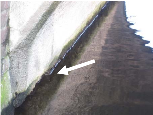
Schade: Verweerd voegwerk op de waterlijn. Oorzaak: Natuurlijk verweer. Risico: Aantasting duurzaamheid steunpunt. Maatregel: Herstel voegwerk op de waterlijn.
