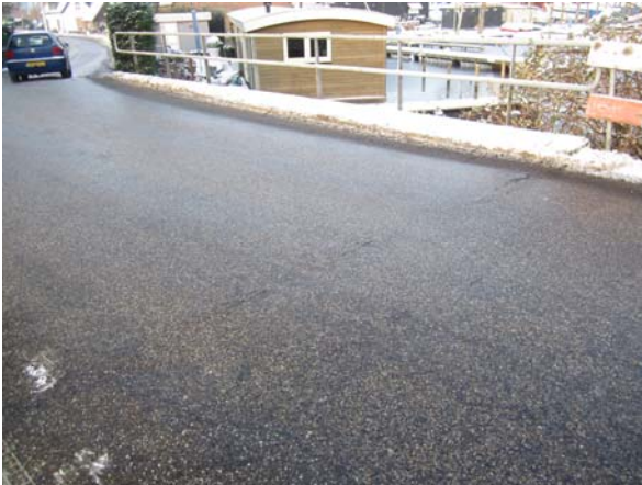
Schade: Scheurvorming in asfalt tpv oostelijk steunpunt. Oorzaak: Werking van materialen. Risico: Indringen dooizouten waardoor in het onderliggende betonnen dek betonschades ontstaan. Maatregel: Inzagen asfaltlaag en vullen met bitumen.
