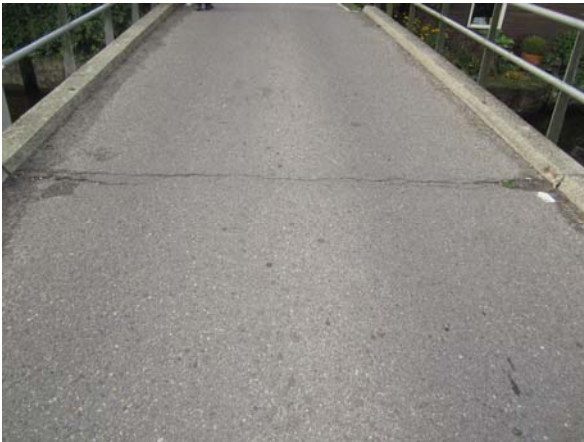
Schade: Scheurvorming in asfalt tpv tussensteunpunt. Oorzaak: Werking van materialen. Risico: Afname rijcomfort, aantasting functionaliteit. Maatregel: Inzagen asfaltaag en vullen met bitumen.
