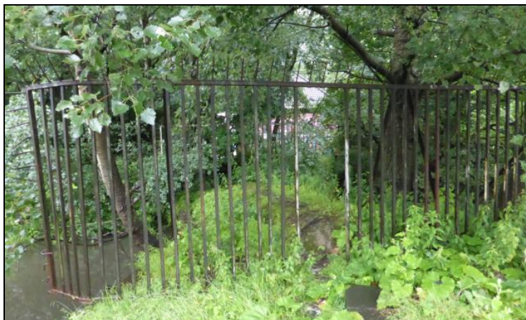
Afbeelding 11. Impressie locatie zinker en bomenkap. De bomen op de gronddam worden gekapt.
