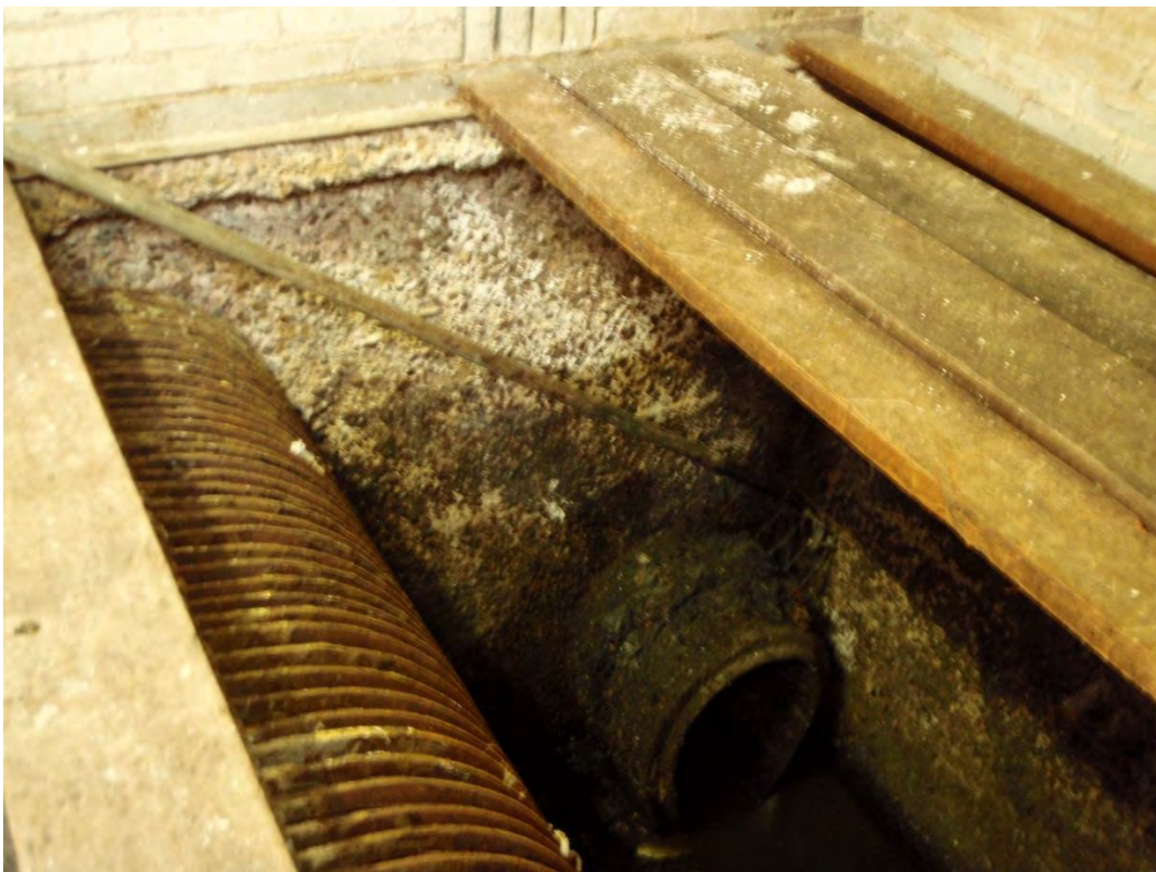
Foto 8 - Balkenvloerdelen en betonwand natte kelder
