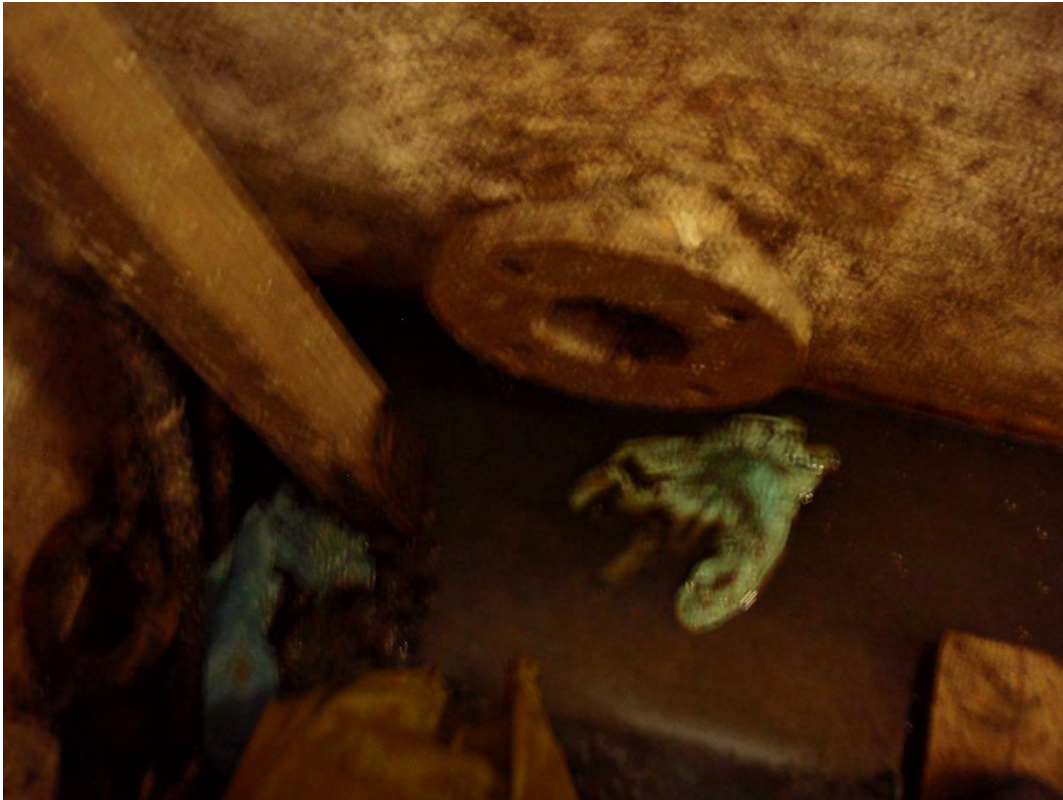
Foto 17 – Droge kelder vervuild met rommel/ geen blindplaat aanwezig op FFM stuk aan zijde droge kelder
