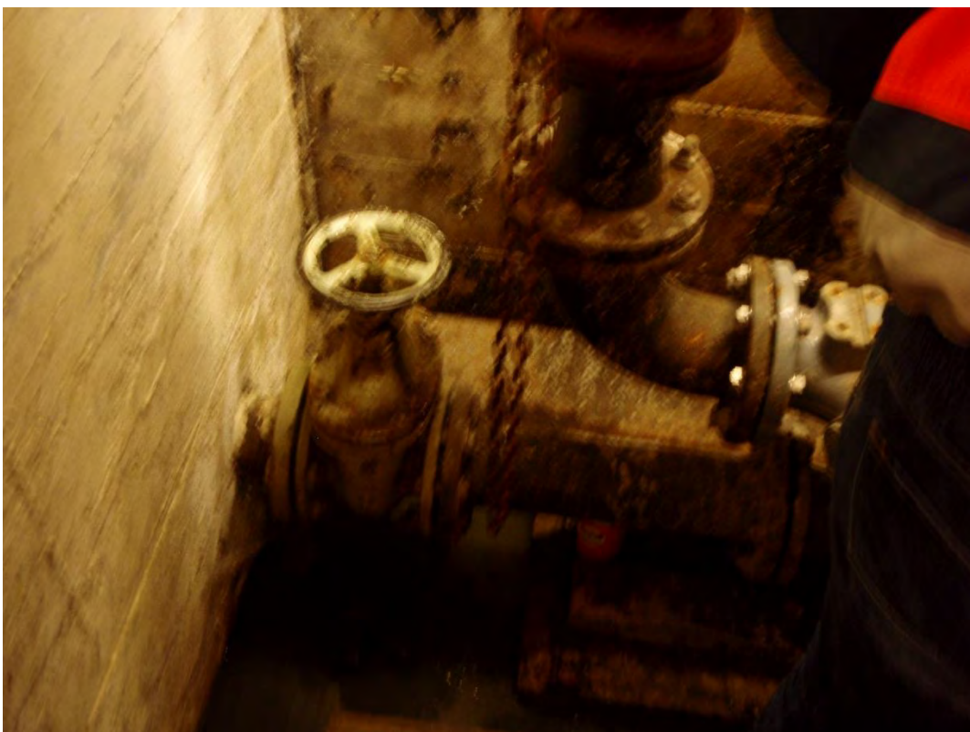
Foto 18 – Gietijzeren appendages zijn gecorrodeerd
