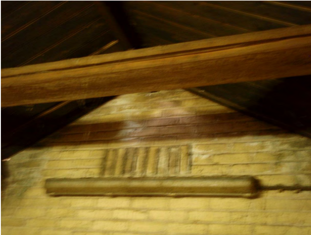
Foto 11 - Defect of buiten gebruik gesteld elektrisch component aanwezig in natte bovenbouw
