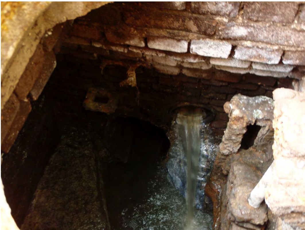
Foto 20 – Niet gangbare spindelschuifafsluiter en turbulente instroom lozingspunt persleiding
