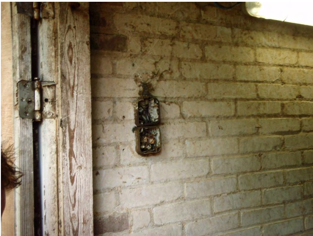
Foto 12 - Defect of buiten gebruik gesteld elektrisch component aanwezig in natte bovenbouw
