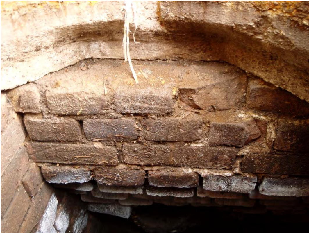
Foto 21 – Noodoverlaat in inspectieput direct bovenstrooms van gemaal
