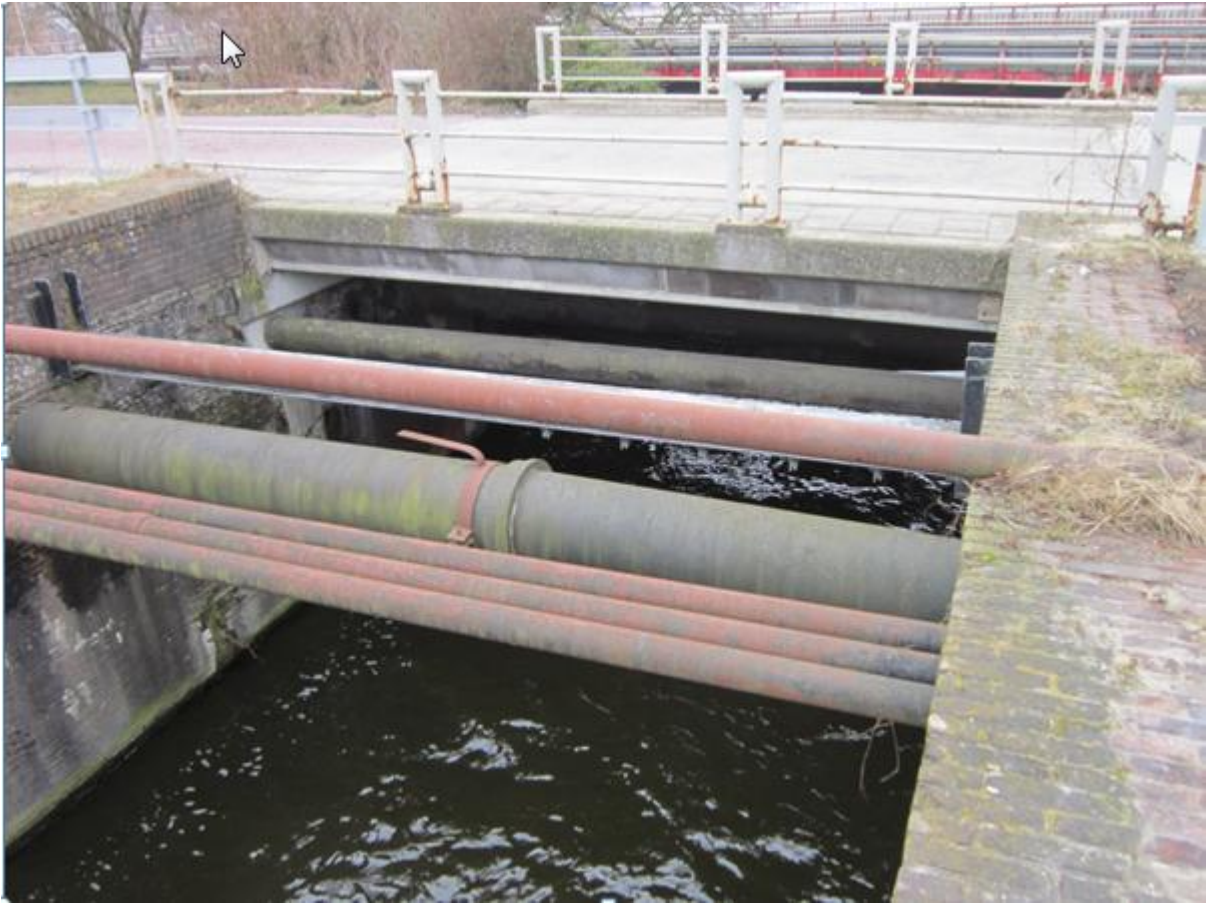
Afbeelding 41: De industriële pijpleidingen bij de Westsluis, huidige situatie
