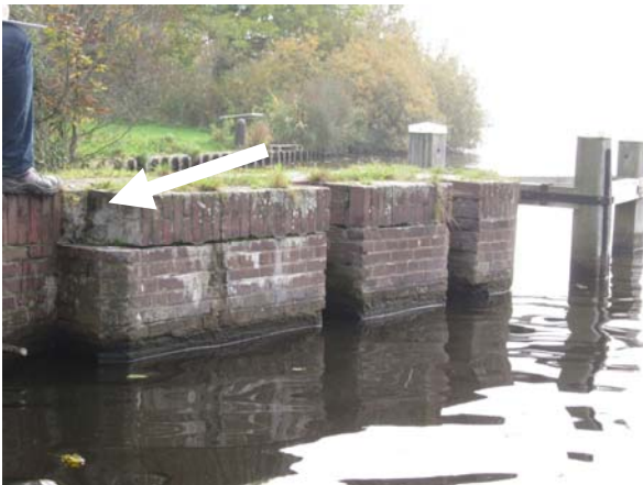
Schade: Ontbrekende metselwerk, verweerd voegwerk. Oorzaak: Natuurlijk verweer. Risico: Aantasting duurzaamheid kademuur. Maatregel: Herstel metselwerk.
