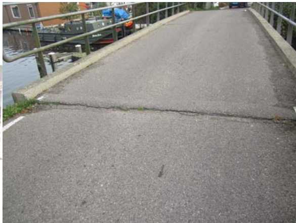
Schade: Asfalt is verzakt en gescheurd. Oorzaak: Zetting van de grond. Risico: Verdere zetting van de grond. Maatregel: Eventueel stootplaten aanbrengen of opnieuw stellen, grond aanvullen en nieuw asfalt aanbrengen.
