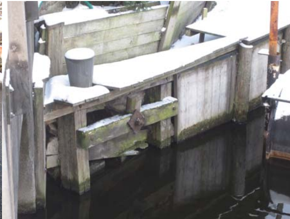
Schade: Houten damwand ontbreekt deels. Oorzaak: Niet aangebracht. Risico: Uitspoeling grond in toekomst. Maatregel: Monitoren
