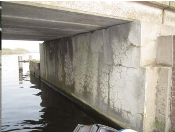
Schade: Craqueléachtige scheurvorming. Oorzaak: Vermoedelijk ASR aantasting. Risico: Bezwijken van de brug. Maatregel: ASR onderzoek.
